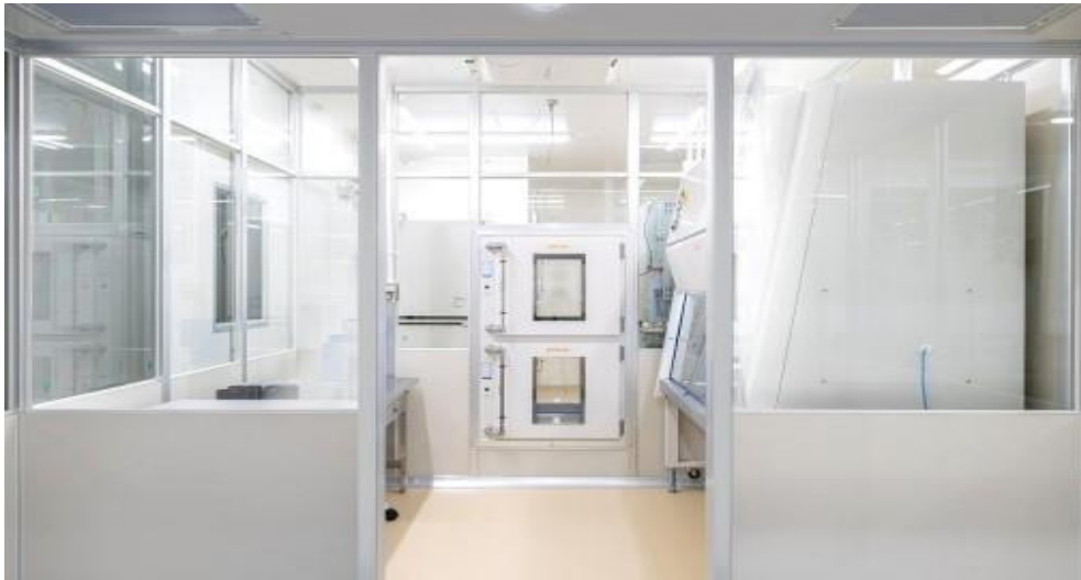
図表8-8. セラボ殿町施設内のエアバリアCPF
