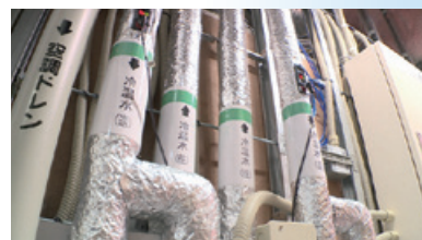
番組中で紹介された「エネフィス九州」機械室
