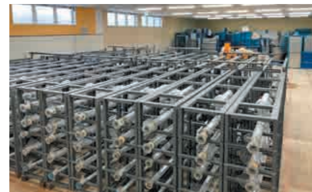
加工済み配管ユニット
